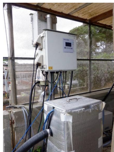
BOD監視システム
