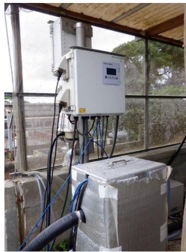
BOD監視システム
