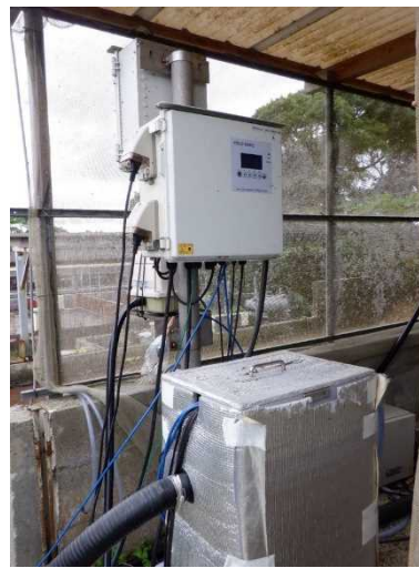
BOD監視システム
