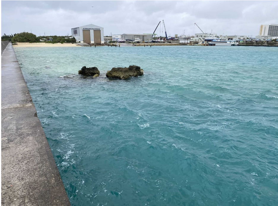
強風や航走波により水域の静穏性が悪化している状況 船揚場(1)(北)整備箇所周辺 (令和5年10月撮影)
