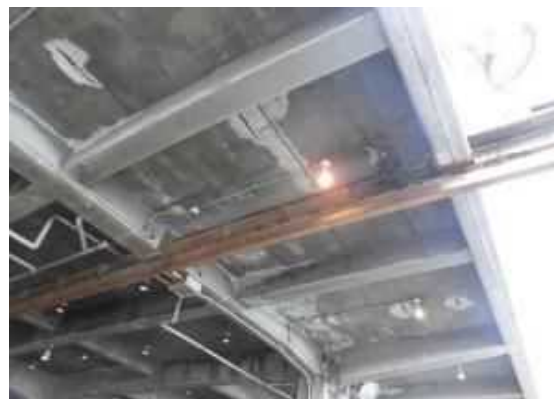
底部分の腐食（コンクリート剥離、鉄筋腐食）
