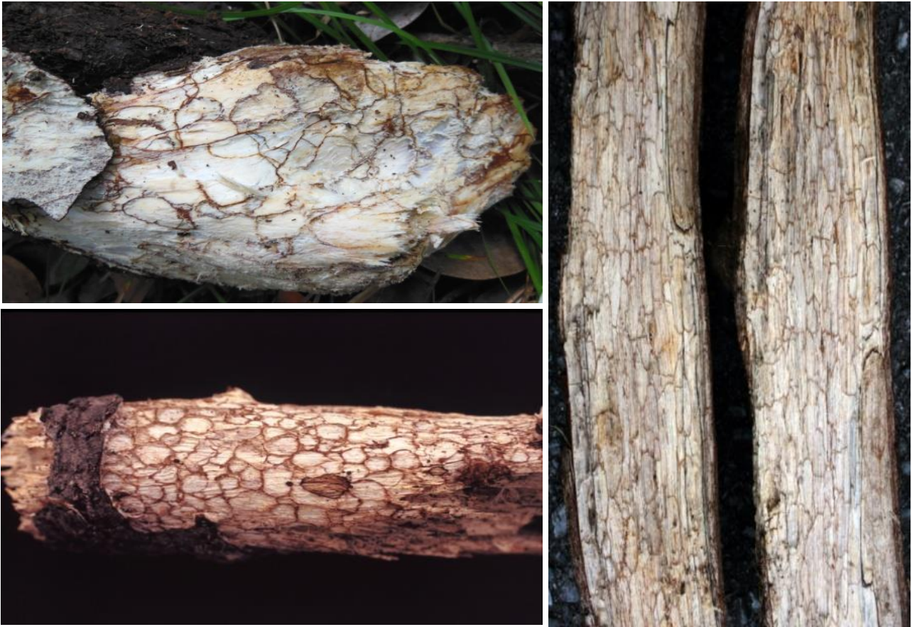
図-4 茶褐色の菌体がライン状に入り込み蜂の巣状を呈した腐朽材
