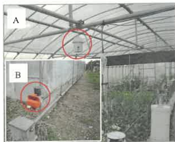
図1 自動巻き上げ機による保温管理 A: 温度センサー B: 自動巻き上げ機
