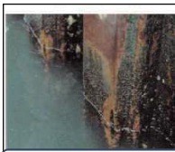
腐食が進行した矢板岸壁
