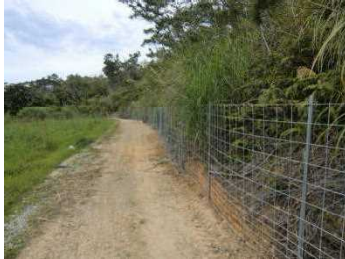
イノシシ侵入防止柵
