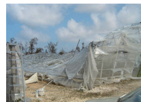
園芸施設の被害
