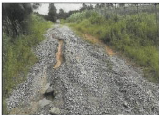
洗掘された農道
