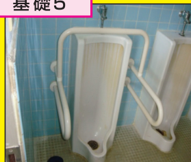
トイレの手すり
