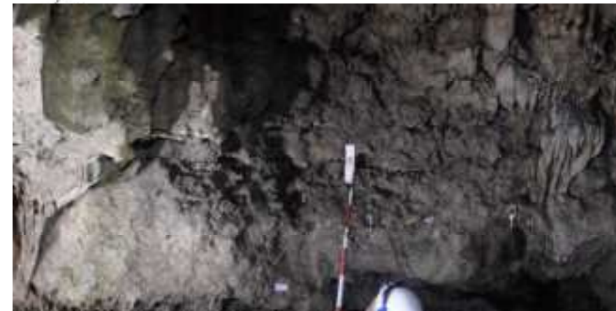
天井部から1mほど上部に、天井に平行に5~10cm開口した亀裂が長さ（連続性）2~3m程度で分布している。
