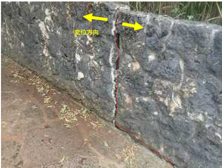
写真 I-2-56 歩道部 側壁の割れ
