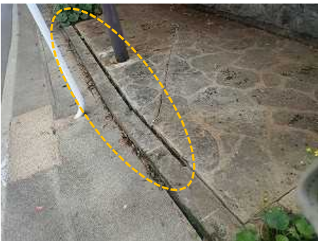
写真 I-2-59 縁石周りの亀裂
