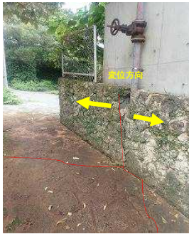
写真 I-2-53 芸大防火設備の割れ
