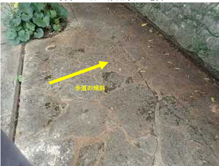
写真 I-2-62 歩道が擁壁に向かって傾斜
