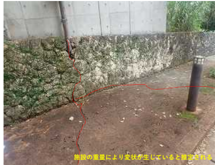
写真 I-2-55 芸大防火設備の割れ
