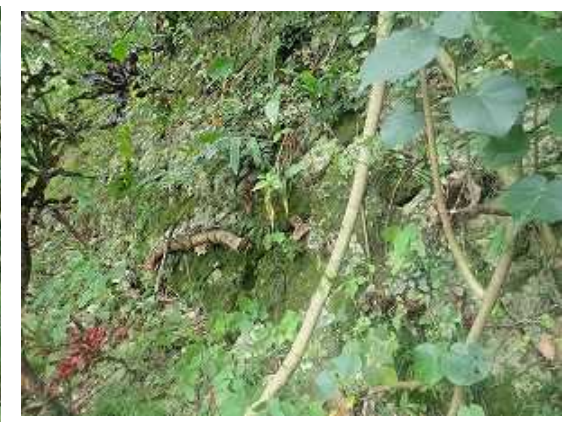
写真 I -2-45 守礼門下の石積み擁壁 はらみ出しが見られる
