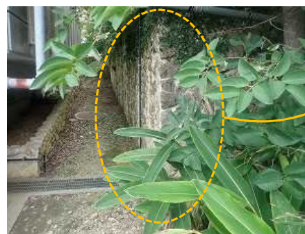
写真 I -2-50 擁壁の倒れこみ
