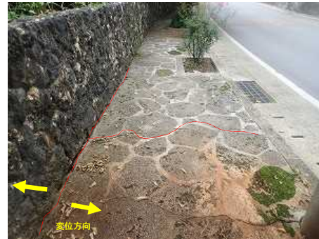
写真 I-2-57 歩道部 側壁の割れ 歩道部から車道部へ向かっている
