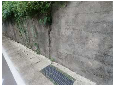
写真 I-2-61 車道反対側の擁壁の割れ
