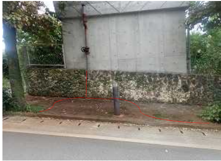
写真 I-2-54 芸大防火設備の割れ
