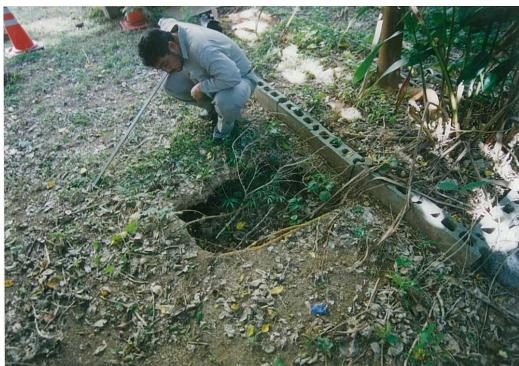
写真 I-2-19 平成14年1月8日頃発生した陥没
