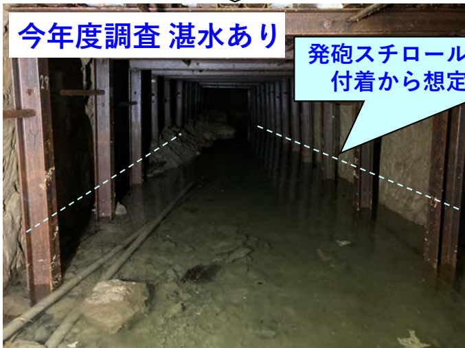
水没時 第3坑道の状況①(令和3年7月)
