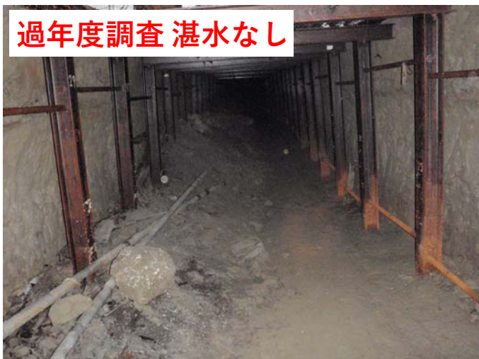
通常時 第3坑道の状況①(平成23年5月)
