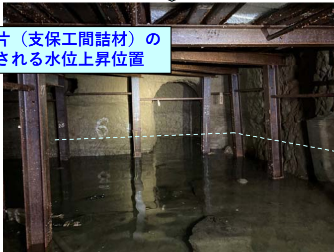
水没時 第3坑道の状況②(令和3年7月)
