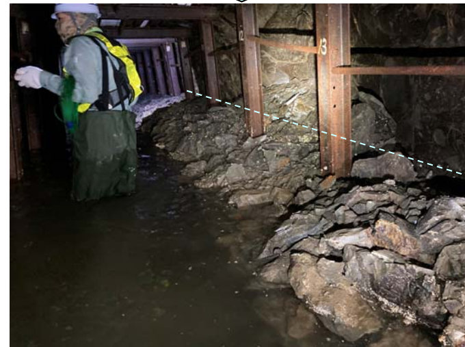
水没時 第2坑道の状況(令和3年7月)
