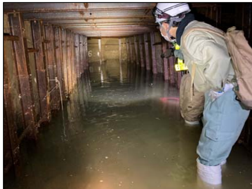
① 第3坑道の湛水状況
