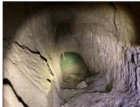
② エンジニアリングトンネルの水没状況
