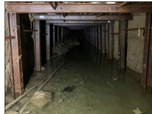
③ 第3坑道の湛水状況
