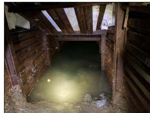
⑤ 第2坑道奥の水没状況
