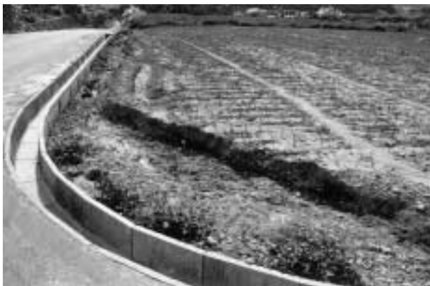
図4. 構造的に侵食されやすい農地。1980年代までに土地改良事業で造成された農地は、沖縄の集中的な降雨が考慮されておらず、排水溝を溢れた雨水が農地を侵食している。
