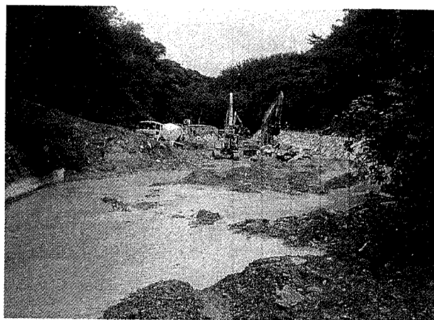
図4. 源河川落差工工事の様子。重機、トラックが行き交い、常時土砂と水が接触するため、赤く濁った水が流れ川底には赤土が堆積している。
