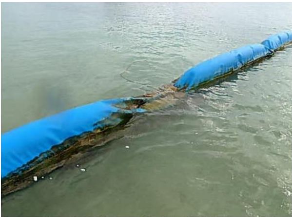
フロートの結合部が沈下している
