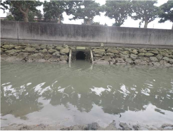
No-⑤地点状況
