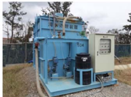
写真8 濁水凝集処理装置
