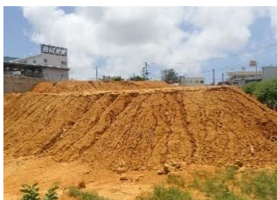
⑤ 法面に発生したリル侵食
