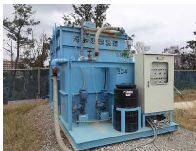
写真16 濁水凝集処理装置
