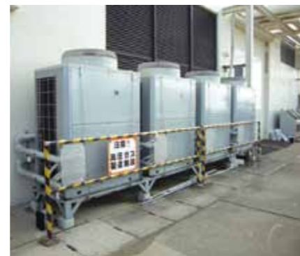
導入したヒートポンプ給湯機
