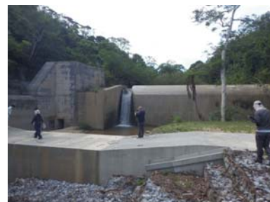
写真 溪流取水施設
