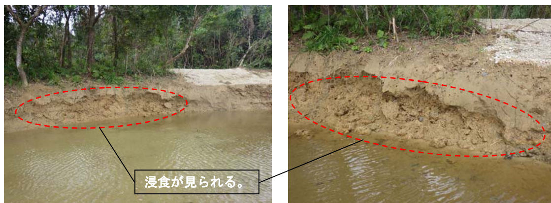
図 1.3.2-9 ワンド壁面の状況(平成 29 年 2 月 11 日撮影)
