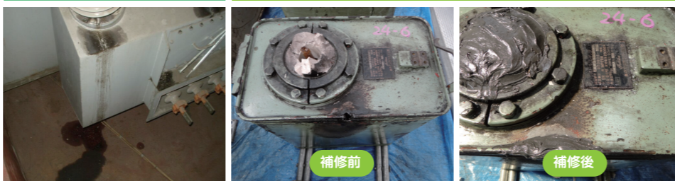
漏洩廃電機器の例
