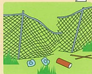
◀フェンスが壊れていたり ゴミが散乱している場所
