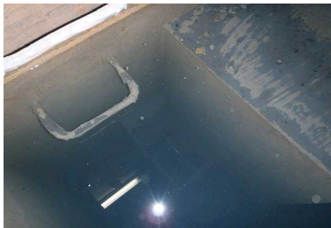
沈殿槽の例（西原小学校）
