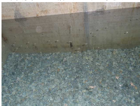
簡易砂ろ過槽（金武小学校）
