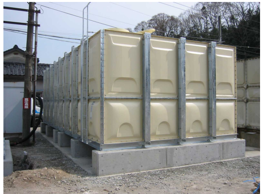
地上設置タイプ（FRP製）
