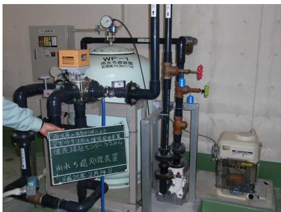
雨水ろ過処理装置及び薬注装置
