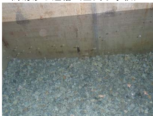
簡易砂ろ過槽（金武小学校）
