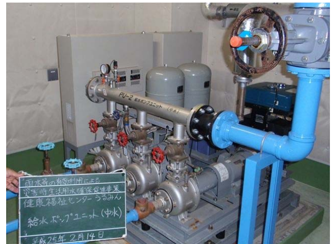
雨水用給水ポンプユニット
