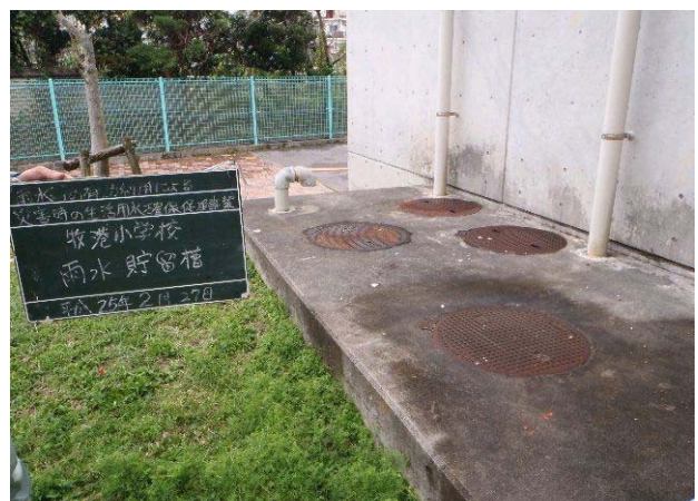
地下埋設タイプ（鉄筋コンクリート製）
