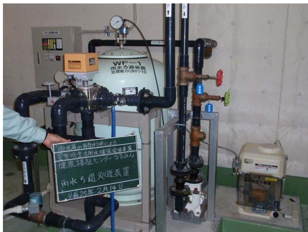
雨水ろ過処理装置及び薬注装置
