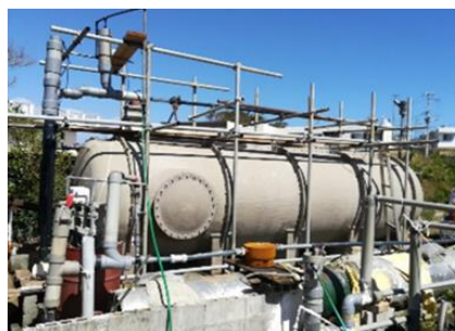
図2 県産技術を活用した 10m 3 メタン発酵槽
